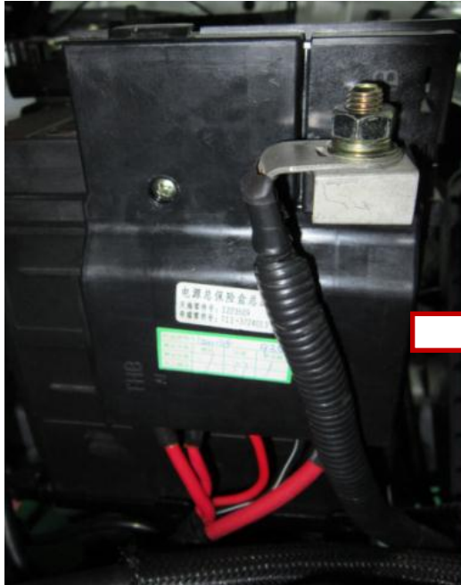
Caja de fusibles de potencia
