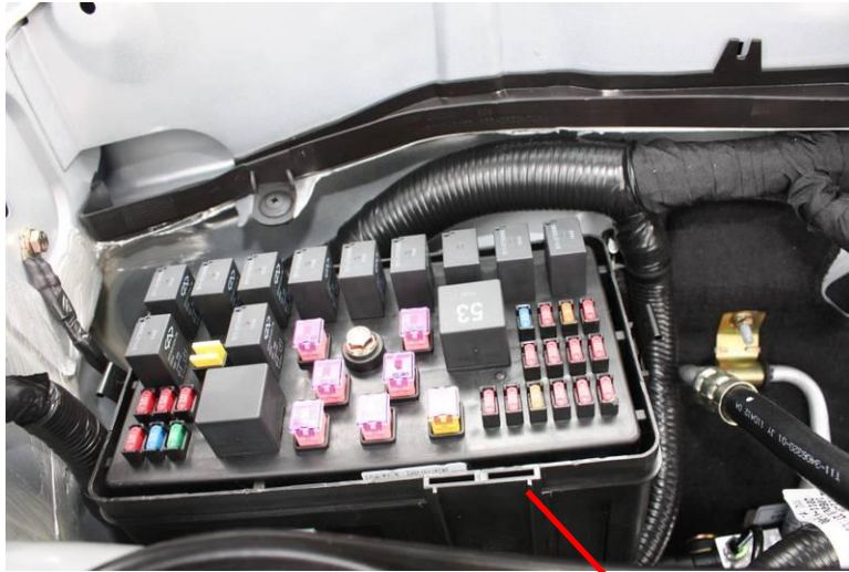
Fusibles del compartimiento del motor y la caja de relés
